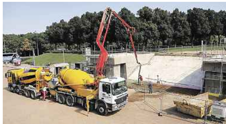
Kopfbauten NO, Betonage der unteren Podestplatte der Treppe, bei den angrenzenden Kopfbauten werden die Natursteinabdeckung demontiert und eingelagert und die Betondecken abgebrochen. Fotos: Ronald Börner
